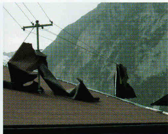
30. April – 12.56 Uhr / Sturmschäden in Eben - Aufräumarbeiten.
