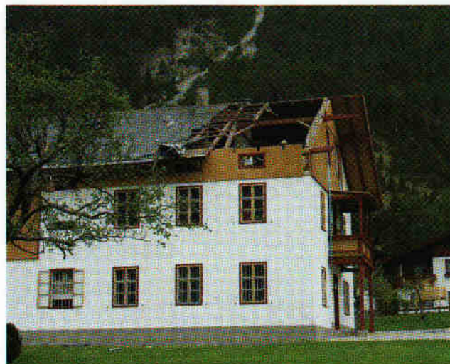
30. April – 12.56 Uhr / Sturmschäden in Eben - Dachstuhl-sicherung.
